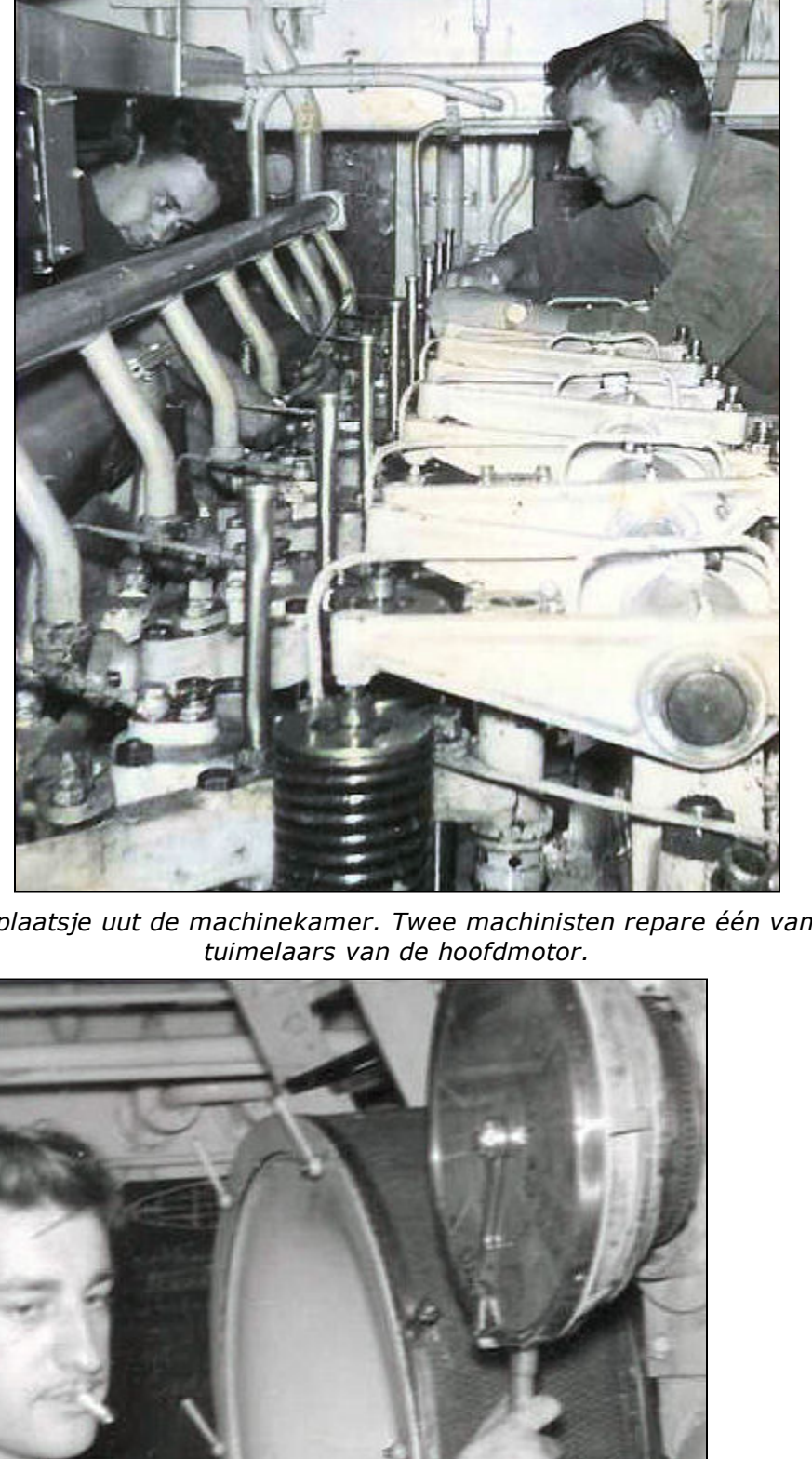
Een plaatsje uit de machinekamer. Twee machinisten repare één van de tuimelaars van de hoofdmotor.
